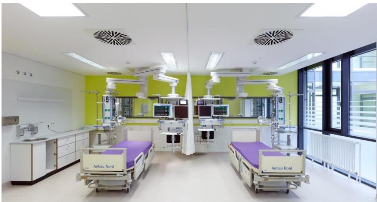
Abbildung 55 Bettzimmer mit deckenhängender Medienversorgungseinheit (Beispiel: Uniklinikum Freiburg)
