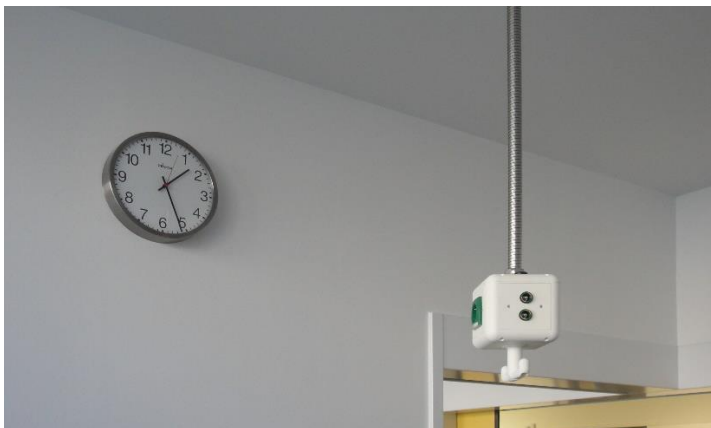
Abbildung 50 Steckdosenwürfel am Fußende (LMU Großhadern)
