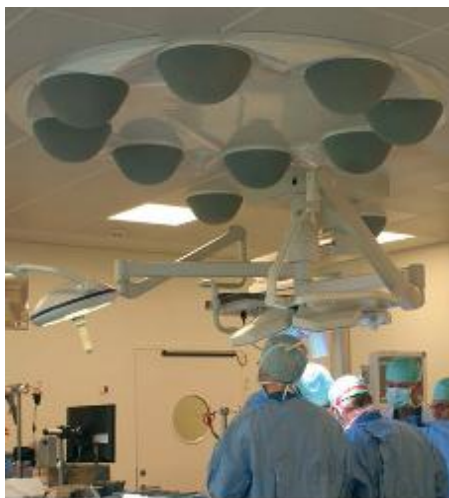
Abb. 31: Temperaturkontrollierter Airflow – TAF-Zuluftauslässe
